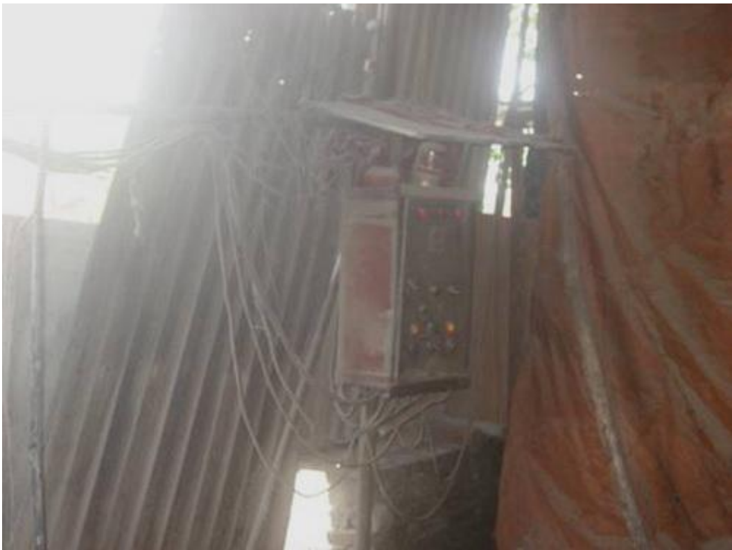
(Hệ thống điện trông rất mất an toàn.)
